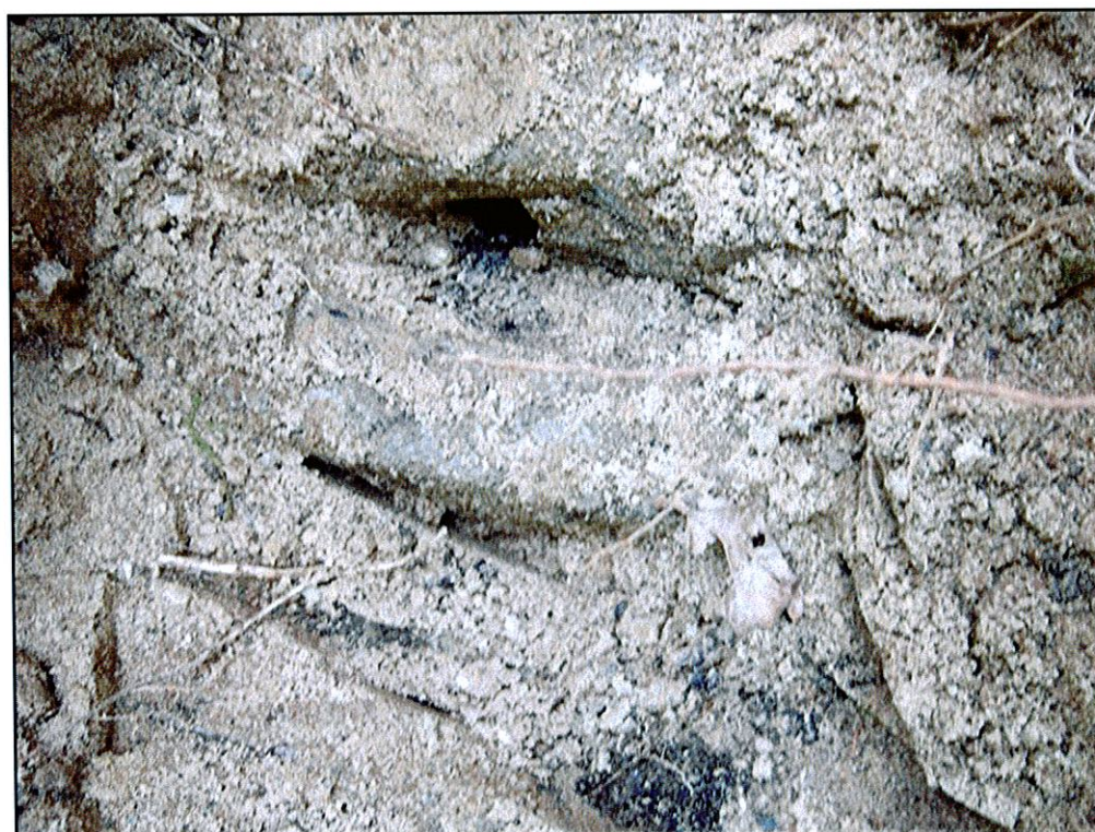
Fot. 4.: Nieszczelna pokrywa studni nr 15
