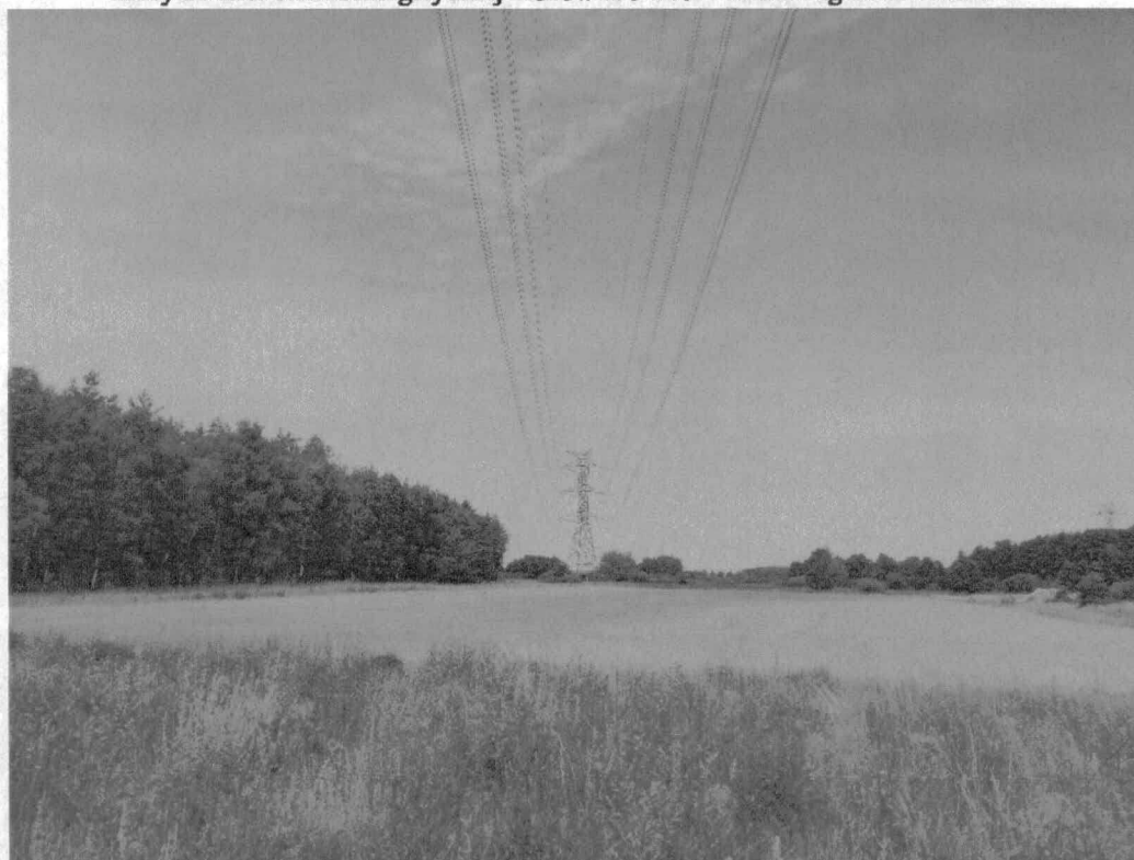
Zdjęcie nr 2. Słup nr 3 napowietrznej dwutorowej linii 2 x 400 kV – dla układu wyprowadzenia mocy do sieci elektroenergetycznej bloków nr 9 i 10 – widok fragmentu obiektu.
