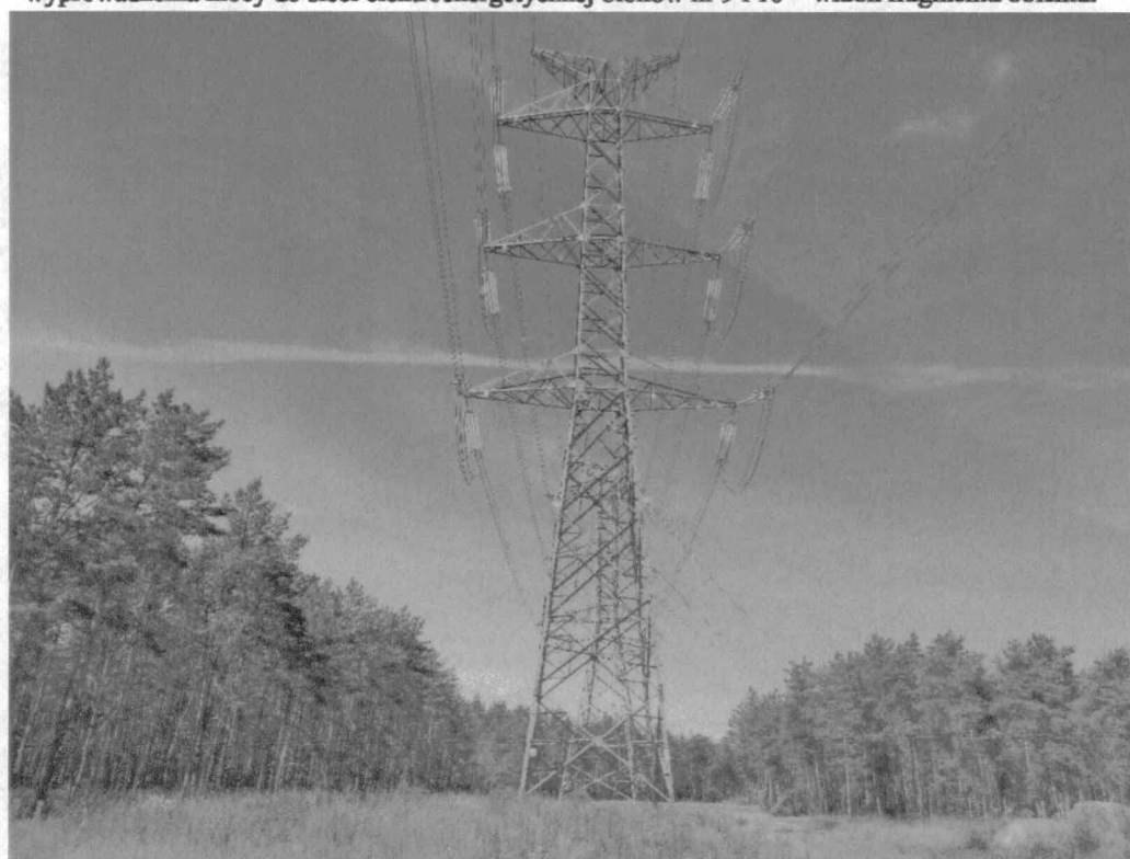
Zdjęcie nr 4. Słup nr 8 napowietrznej dwutorowej linii 2 x 400 kV – dla układu wyprowadzenia mocy do sieci elektroenergetycznej bloków nr 9 i 10 – widok fragmentu obiektu.
